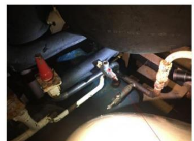
Ammoniakk lekk fra denne ventilen. Faksimile: Sjøfartsdirektoratet
